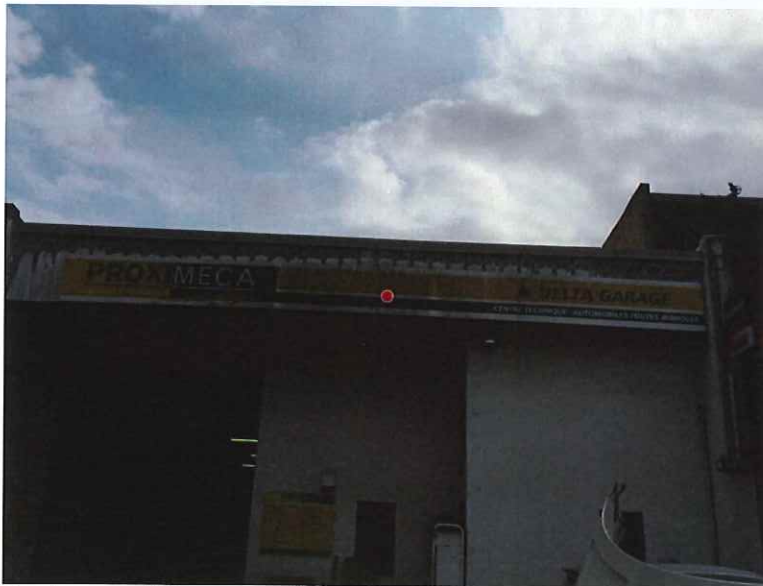
Enseigne parallèle en mauvais état d'entretien, Mouans-Sartoux.
