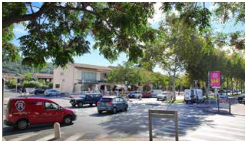
A partir du mois d'octobre, création d'un giratoire à l'angle de l'avenue de Cannes et de l'allée du Parc.
