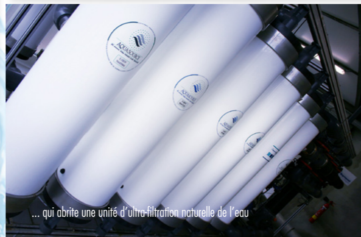
La station de traitement de la Source de la Foux...
