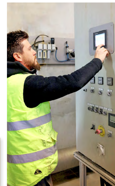
Julien Vanghent dans la station d'ultrafiltration de la Source de La Foux
